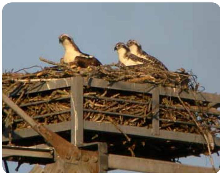
Pylône RTE Dampierre le 8 juillet 22 © RTE
